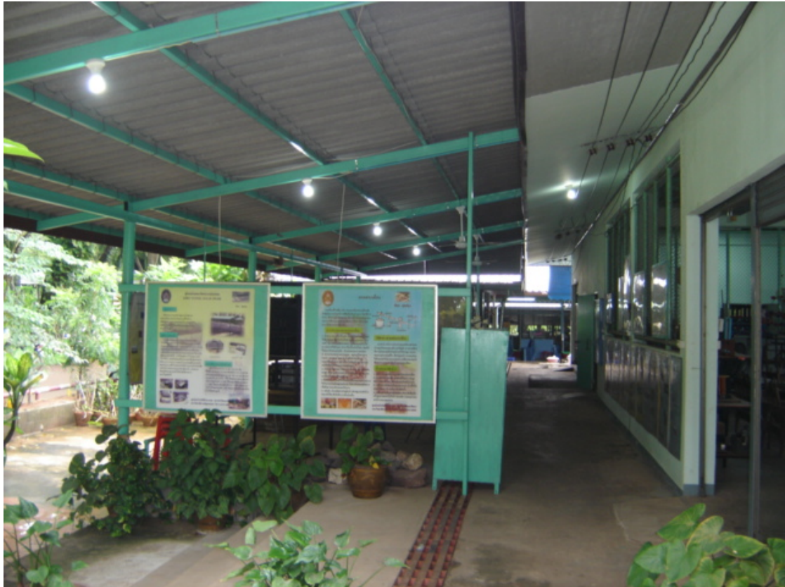
รูปแสดงการติดตั้งหลอดแสงสว่างรอบอาคารศูนย์เทคโนโลยีที่เหมาะสม
