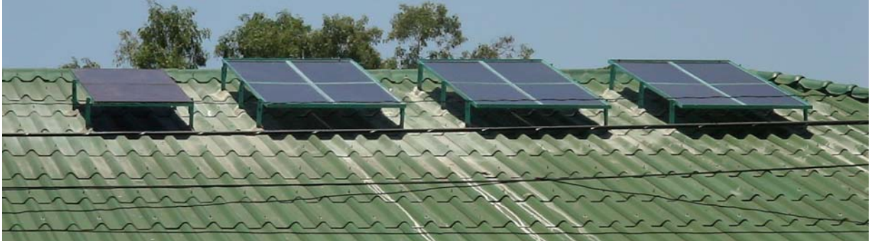
รูปแสดงการติดตั้งแผงเซลล์แสงอาทิตย์ ศูนย์เทคโนโลยีที่เหมาะสม
