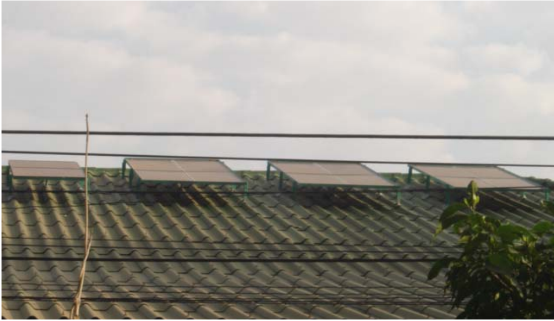
แผงแสงอาทิตย์ที่ติดตั้งอยู่บนหลังคาอาคารของศูนย์ฯ
