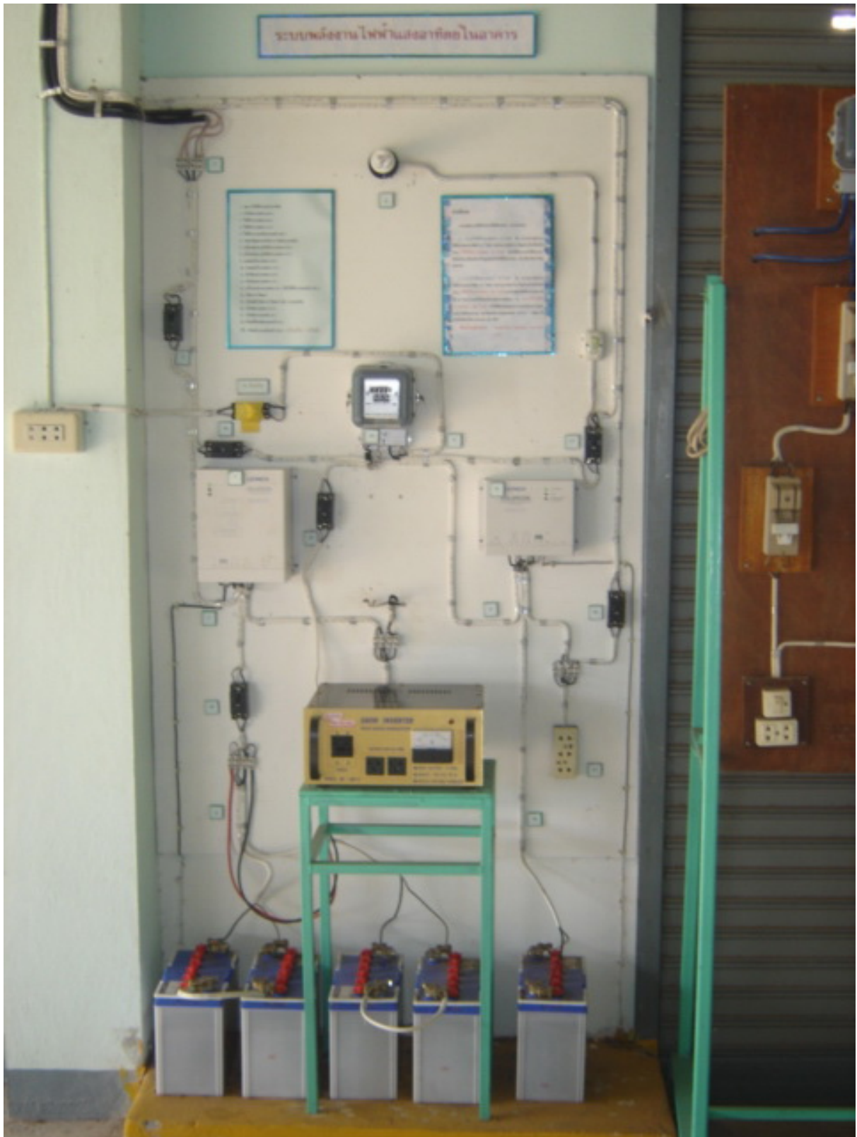
แผงควบคุมระบบไฟฟ้าแสงอาทิตย์
